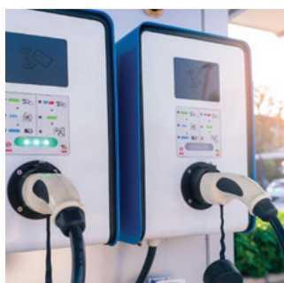
Estaciones de carga para vehículos eléctricos
